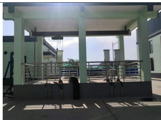
二级提升泵池
